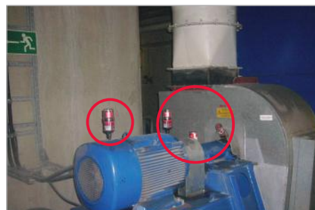
Lubrificazione di un motore elettrico e dell'albero di un ventilatore per l'aria secondaria
