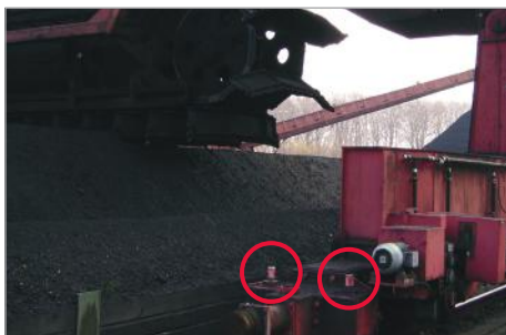
Lubrificazione di un supporto su rulli di supporto
