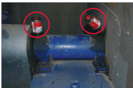
Lubrificazione di un cuscinetto di supporto su un ventilatore
