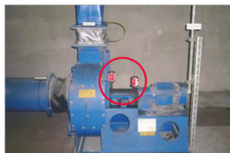
Lubrificazione di un albero di comando su un ventilatore
