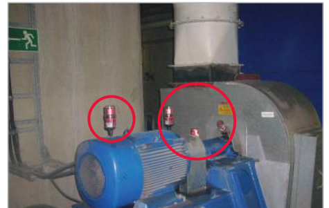
Lubrification d'un moteur électrique et de l'arbre d'un ventilateur secondaire
