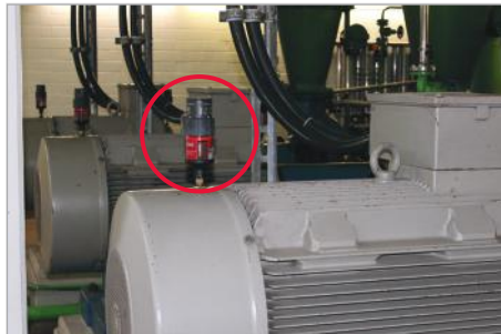
Lubrification d'un moteur électrique
