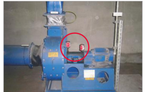
Lubrification de l'arbre moteur d'un ventilateur
