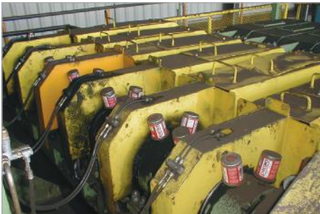
Lubrification du palier à chapeau d'un arbre moteur
