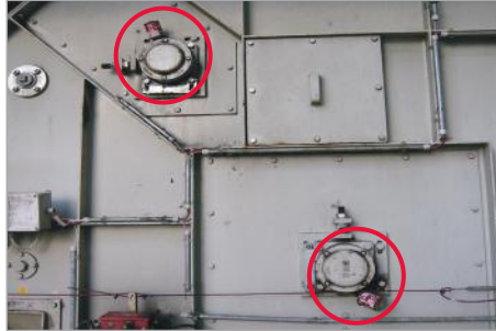
Lubrification du palier de pivotement d'un convoyeur à godets
