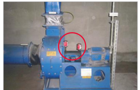
Lubricación del árbol de transmisión de un ventilador
