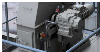
Lubrification des paliers à roulement des convoyeurs sur l'élévateur de remplissage
