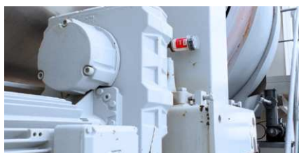
Lubrification de palier de tambour parallèle
