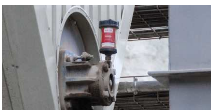
Lubrification du palier de pivotement sur le dé poussiérage de vis en auge
