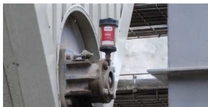
Flanschlagerschmierung an der Trogschnecke Entstaubung
