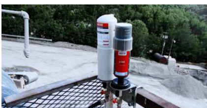
Lubrification du palier d'un convoyeur à bandes
