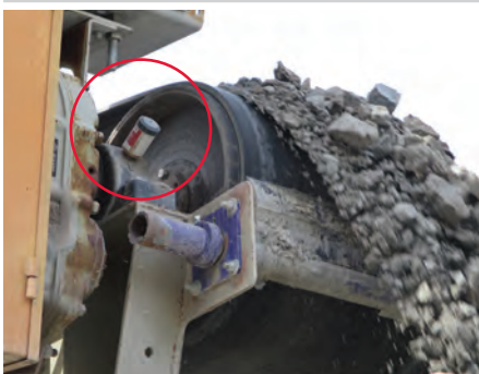
Lubrification du palier fonte d'un convoyeur
