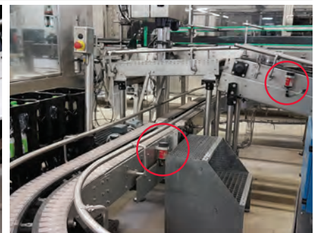
Lubrification de chaîne pour le transport de caisses après l'encaisseuse et le contrôle de caisse pleine
