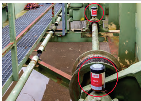
Lubrification de palier à roulement sur le racleur
