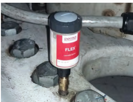
Lubrification de la couronne d'orientation
