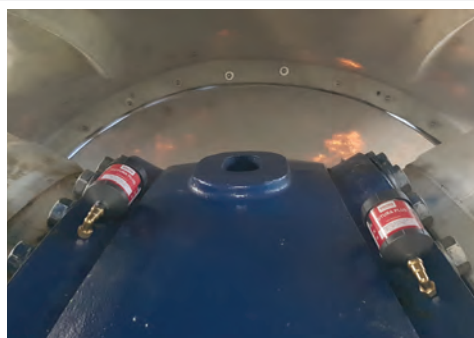
Lubrification des paliers de pale
