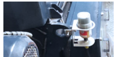
Automatische Nachschmierung der Generatorlager
