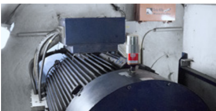
Automatische Nachschmierung der Generatorlager
