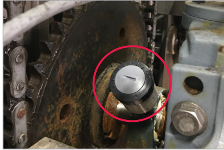
Schmierung eines Stehagers an einer Antriebstrummel
