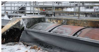
Lubricación de cojinetes del ventilador del tanque aireado
