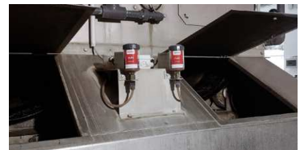
Lubricación del cojinete en el densificador de exceso de lodos
