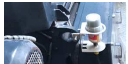
Rilubrificazione automatica dei cuscinetti del generatore
