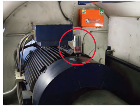
Relubrificação automática do rolamento do gerador
