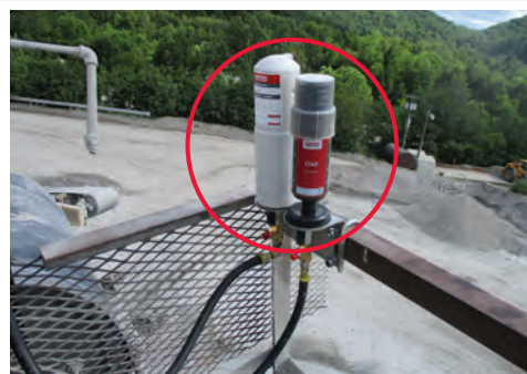
Lubrificação de mancais de um transportador
