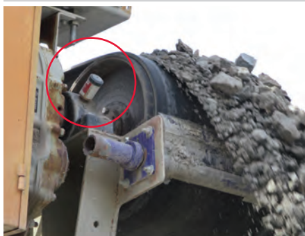
Lubrificação de mancais de um transportador
