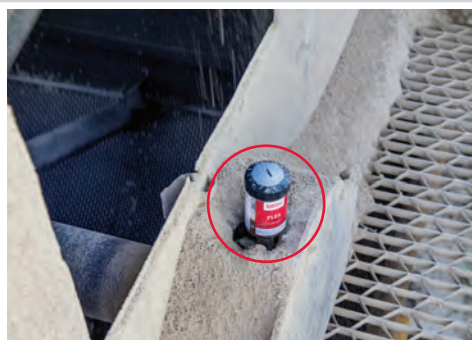
Lubrificação de mancais em peneira de brita e areia
