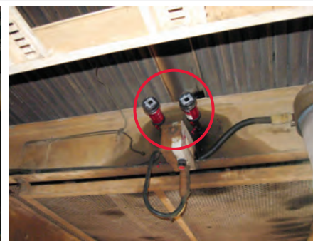
Lubrificazione del ventilatore (fin fan) di un impianto per lo scambio di calore
