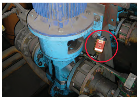
Lubrificazione di una pompa di alimentazione del carburante nel processo di raffinazione
