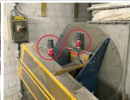
Lubrificazione del cuscinetto su un impianto di ventilazione
