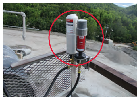
Lubrificazione del cuscinetto di un impianto a nastro trasportatore
