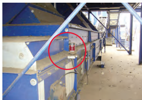
Lubrificazione del supporto a flangia di un impianto a nastro trasportatore
