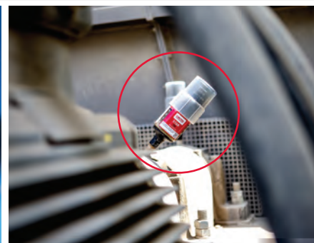
Lubrificazione del cuscinetto di un impianto di ventilazione
