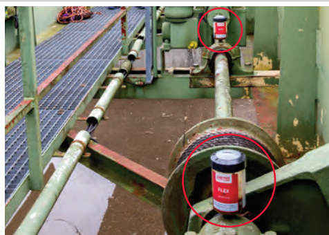
Lubrificazione dei supporti di cuscinetti su raschiatore
