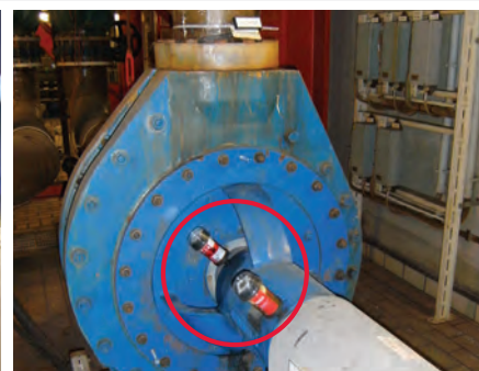
Lubrificazione dell'albero di comando di una pompa
