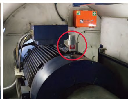
Rilubrificazione automatica dei cuscinetti del generatore
