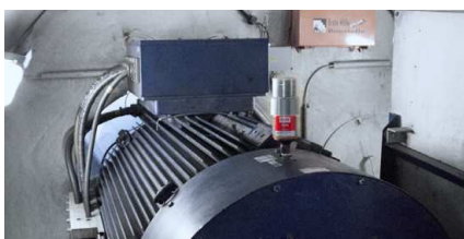
Relubricación automática del cojinete del generador
