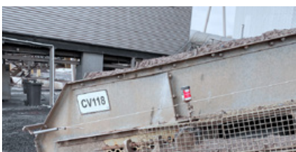
Schmierung des Lagerblocks an einer Antriebsscheibe
