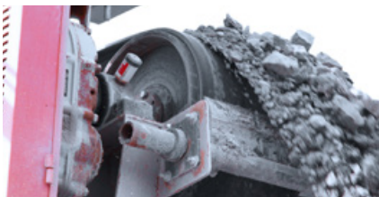
Stehlagerschmierung einer Förderbandanlage
