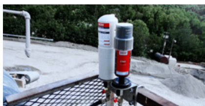
Stehlagerschmierung einer Förderbandanlage
