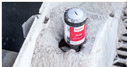
Stehlagerschmierung an Splitt- & Sandsieb
