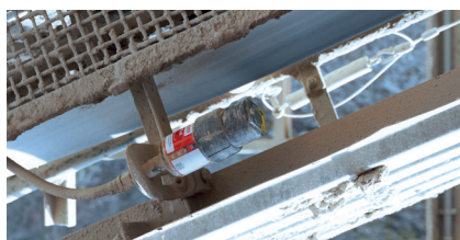
Lubricación del cojinete de una bomba
