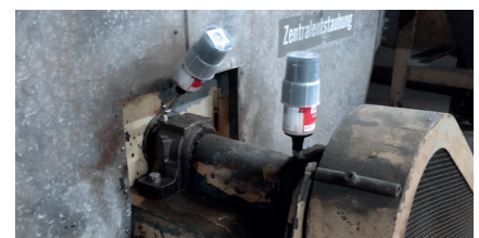
Lubricación del cojinete de un ventilador
