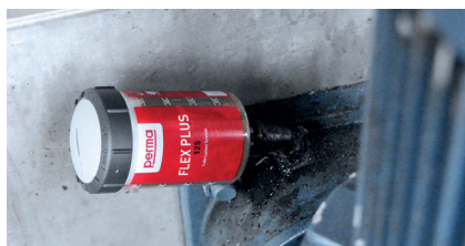
Lubricación del cojinete de una bomba
