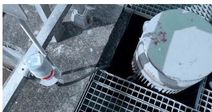
Lubricación de cojinetes de motores eléctricos
