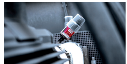
Lubricación del cojinete de un ventilador
