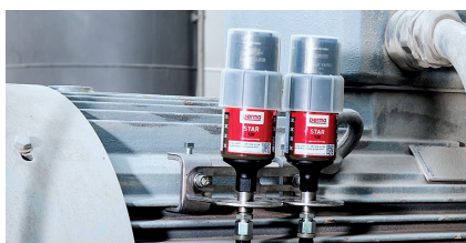
Lubricación de cojinetes de motores eléctricos
