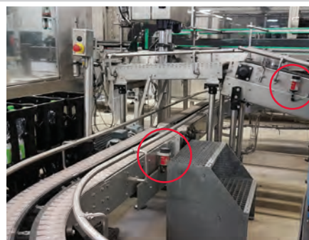
Smarowanie łańcuchów transportera skrzynek za pakowarką i kontrolą pełnych skrzyń
