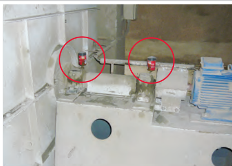
Smarowanie łożyska stojakowego wału wentylatora
