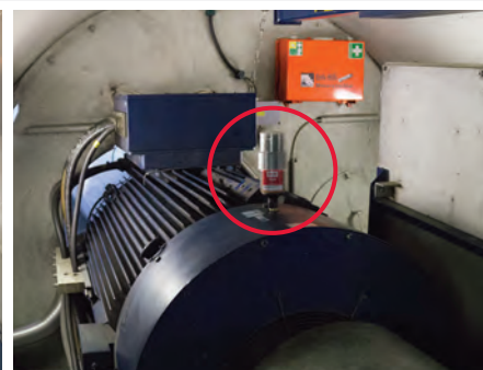
Automatyczne smarowanie łożysk generatora
