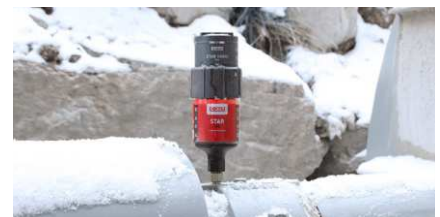
Lubrificazione cuscinetto e tenuta su un sistema di ventilazione
