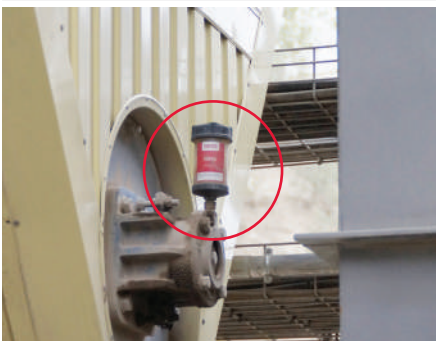
除尘槽式输送机上法兰轴承的润滑
