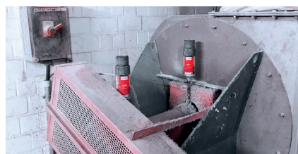
Schmierung eines Gebläselagers
