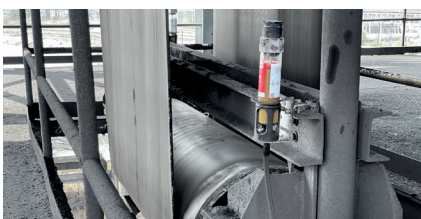
Schmierung einer Schwerkraft-Spannvorrichtung
