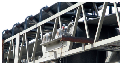
Schmierung einer Schwerkraft-Spannvorrichtung
