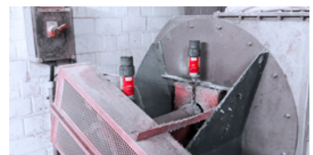
Schmierung eines Gebläselagers
