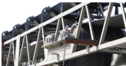
Schmierung einer Schwerkraft-Spannvorrichtung
