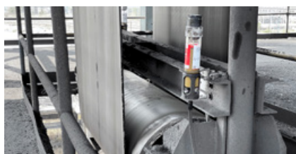
Schmierung einer Schwerkraft-Spannvorrichtung
