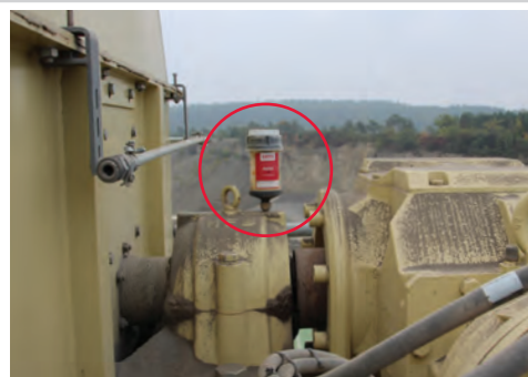
Wälzlagerschmierung am Heißelevator
