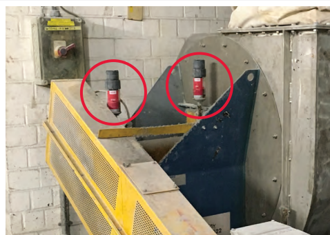
Stehlagerschmierung einer Lüfteranlage
