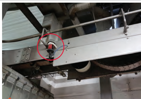
Kettenschmierung am Kastentransport zum Kastenausstoßer
