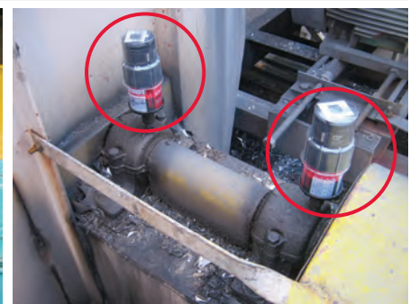
Schmierung einer Lüfterwellenlagerung
