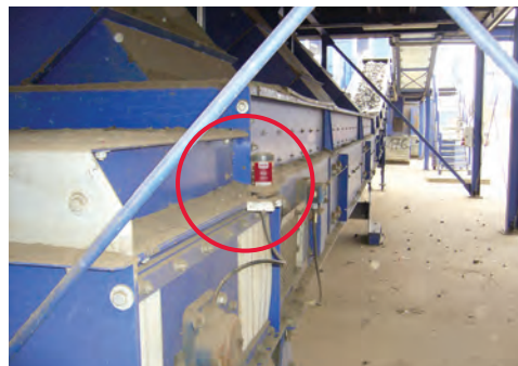
Flanschlagerschmierung einer Förderbandanlage
