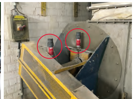
Lagerschmierung an einer Lüfteranlage
