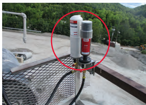
Promazávání stojanových ložisek zařízení dopravního pásu
