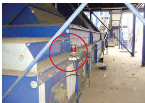
Promazávání přírubových ložisek zařízení dopravního pásu
