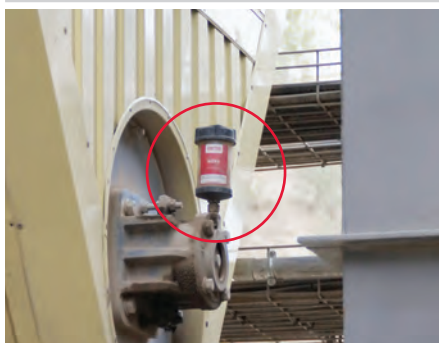
Promazávání přírubových ložisek ve žlabech se šnekovým dopravníkem, odstranění prachu
