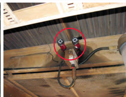
Promazávání ventilátorů (Fin Fan) v tepelném výměníku
