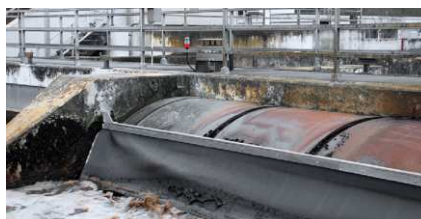
Lubrificazione del cuscinetto del ventilatore del bacino aerato
