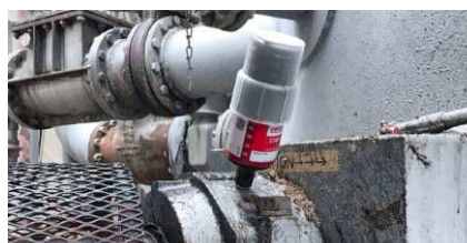
La lubrificazione dei cuscinetti del piedistallo di un impianto di ventilazione
