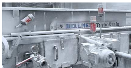
Lubrificazione del cuscinetto di un ispessitore a nastro
