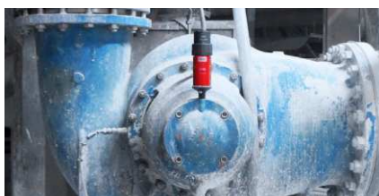
Lubrificazione del cuscinetto su una pompa
