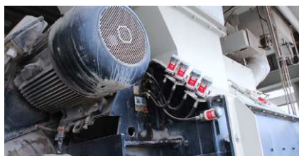
Lubricación de las trampillas de mezclador y de los ejes de mezclador
