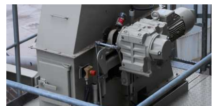
Lubricación de rodamientos en el elevador de llenado
