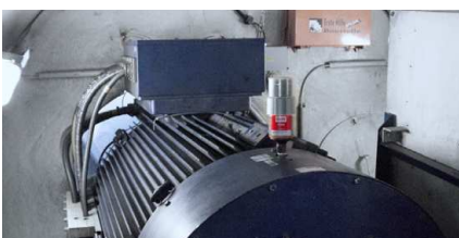
Automatische Nachschmierung der Generatorlager
