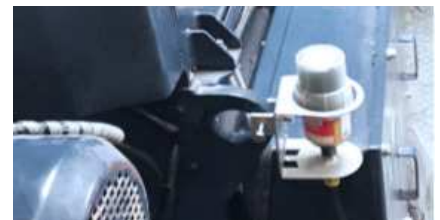
Automatische Nachschmierung der Generatorlager
