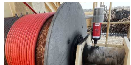
Schmierung von Kranseilrollenlager
