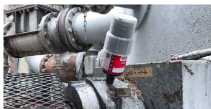
Schmierung der Stehlager an einer Lüfteranlage
