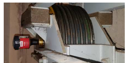
Lubricación de la polea de desvío del cable
