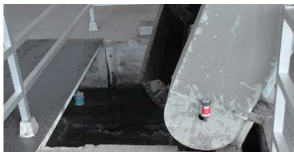
Schmierung an der Kettenumlenkrolle
