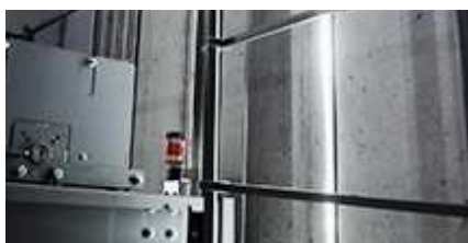
Lubrification des rails de guidage sur les contrepoids
