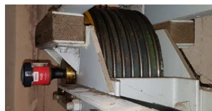
Lubrification de la poulie de renvoi des câbles
