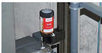
Lubrificazione delle guide della cabina passeggeri
