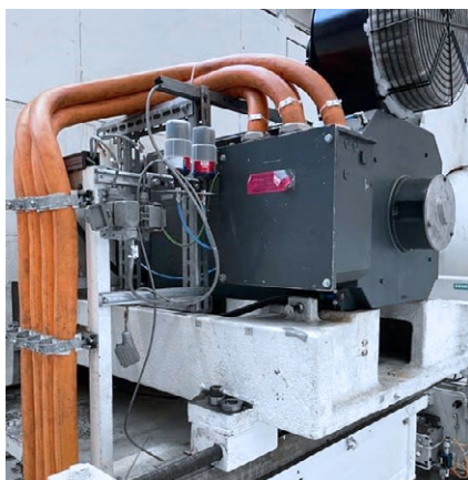
Schmierung eines Elektromotors an einer Presse
