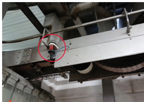
Lubricación de cadena en el transporte de cajas hacia el dispositivo de expulsión de cajas
