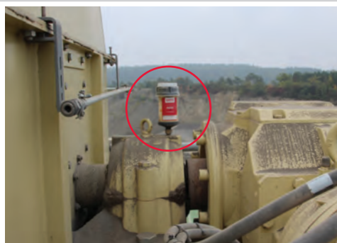
Lubricación del rodamiento en el elevador térmico
