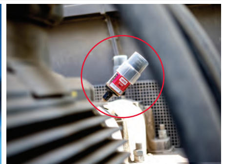
Lubricación del cojinete de un ventilador
