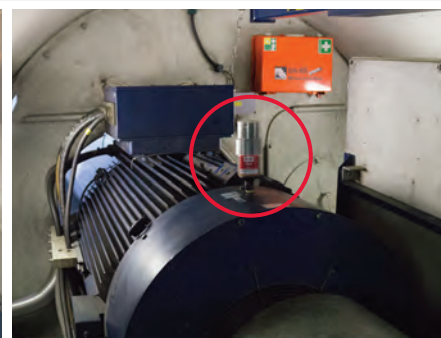
Relubricación automática del cojinete del generador
