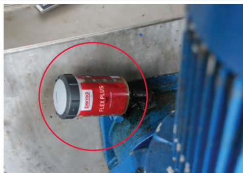
Lubricación del cojinete de una bomba
