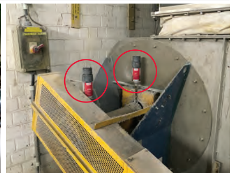
Lubricación del cojinete de un ventilador
