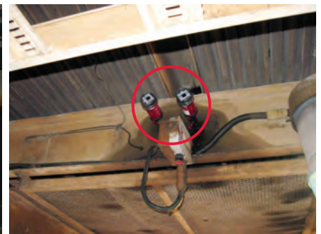
Lubricación del ventilador (Fin Fan) de una instalación de intercambio de calor
