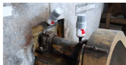
Lagerschmierung einer Lüfteranlage
