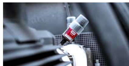
Lagerschmierung einer Lüfteranlage
