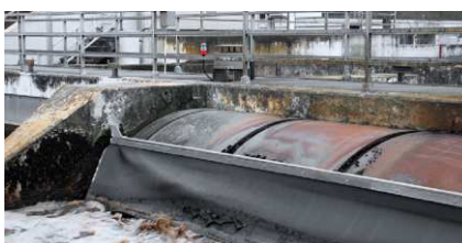
Lubrification de palier du ventilateur du bassin d'aération
