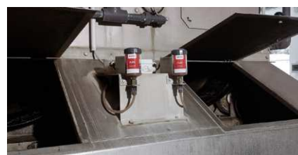
Lubrification du palier sur l'épaississeur de boues excédentaires
