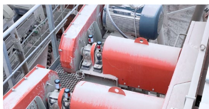
Lubricación del motor de una criba vibratoria
