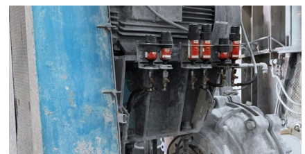
Lubricación de cojinetes | Lubricación de juntas de una bomba
