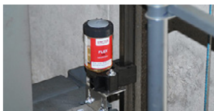
Schmierung der Führungsschienen an der Fahrgastkabine
