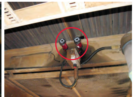
Smring van de ventilator (Fin Fan) van een warmtewisselaarsysteem
