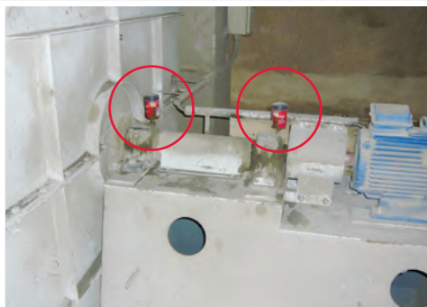
Lagerhuissmering van een Ventilator aandrijfjas
