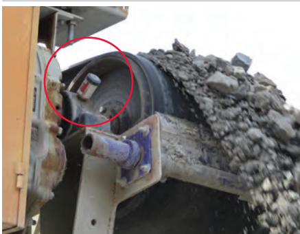
Lagerhuissmering van een transportband
