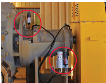
Lager- en afdichtingsmering van een pomp
