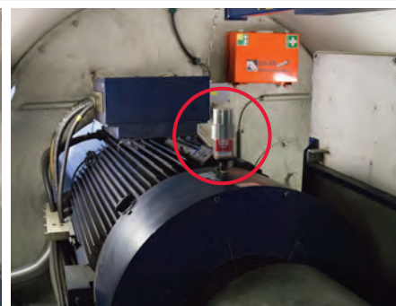
Automatisch nasmeren van de generatorlagers
