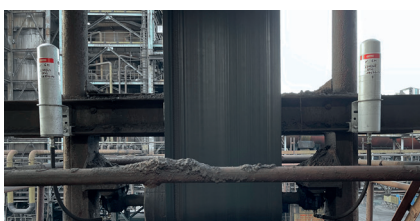
Schmierung einer Förderbandanlage (Spannrolle)
