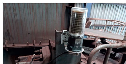
Schmierung einer Förderbandanlage (Antriebstrummel)
