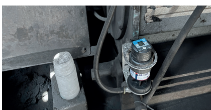
Schmierung an Elektromotoren
