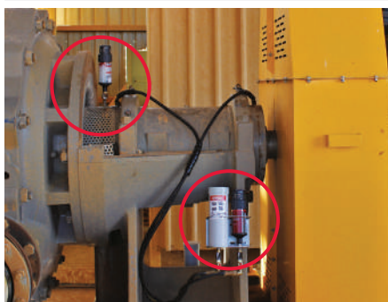
ポンプのベアリング / シールへの給油
