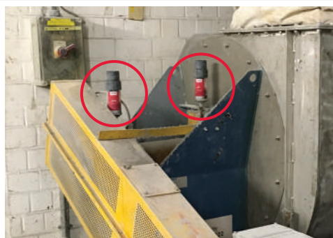
ファンのピローブロックベアリングへの給油
