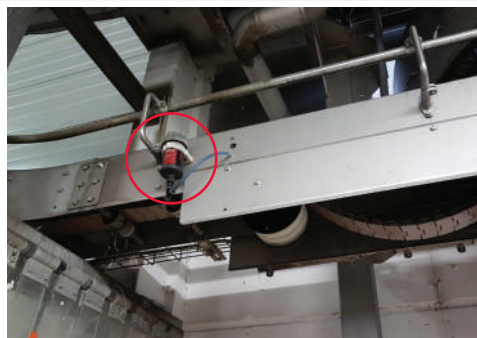
搬送装置のボックス排出機チェーンへの給油
