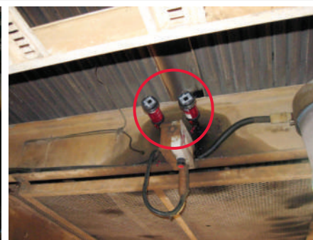
熱交換器のフィン、ファンへの給油
