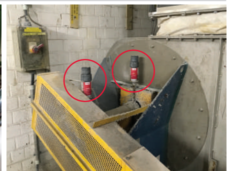
ファンのピローブロックベアリングへの給油
