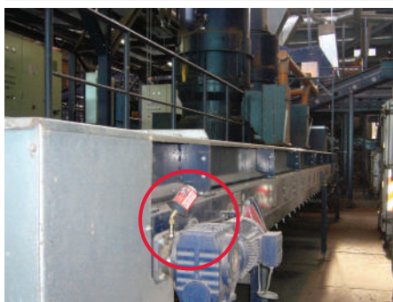
コンベヤーのフランジベアリングへの給油
