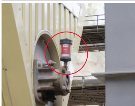
除塵用トラフ式スクリーコンベヤーの、フランジベアリングに設置した給油器
