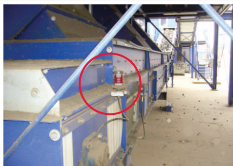
コンベヤーのフランジベアリングへの給油
