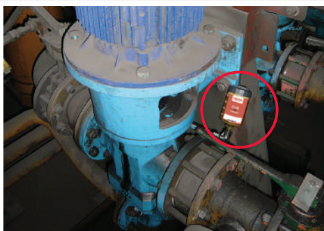
生成処理中の燃料ポンプへの給油
