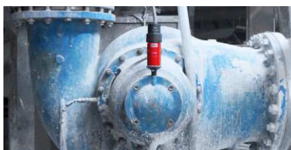
Lubricación de cojinete de una bomba
